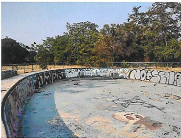
Piscina recreativa. En desuso.
